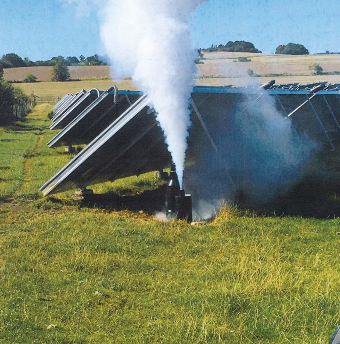
Vædderangeb ødelagde rørforbindelsen og forårsagede et stort tab af varmt vand og glykol. Foto: Leif Jakobsen.
